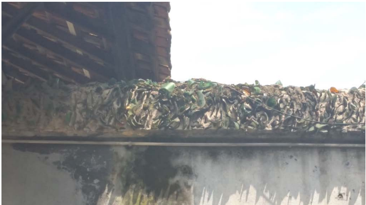
Broken Glass topping Hỏa Lò Wall
